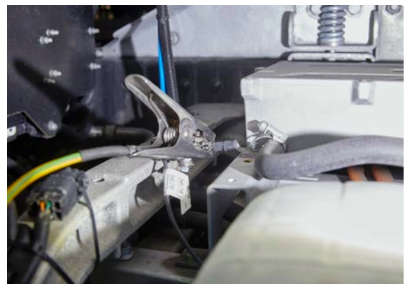
Un idoneo collegamento equipotenziale previene il pericolo di scariche elettrostatiche.
