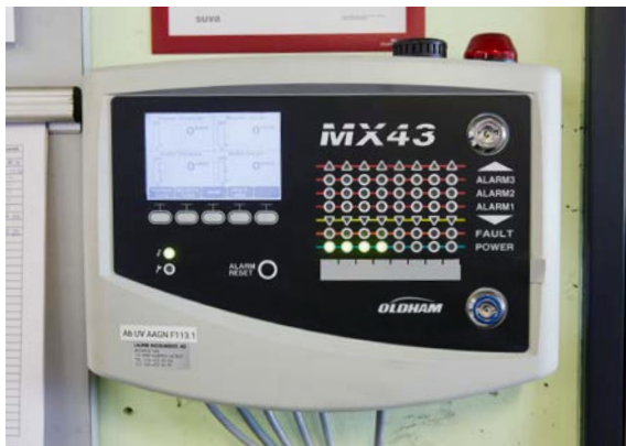
Gli impianti di rilevazione gas rilevano le concentrazioni di gas esplosive.
