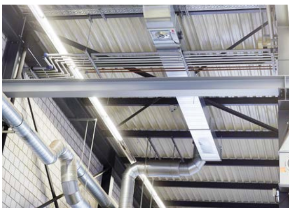
La ventilazione artificiale consente di assicurare un ricambio d'aria adeguato.
